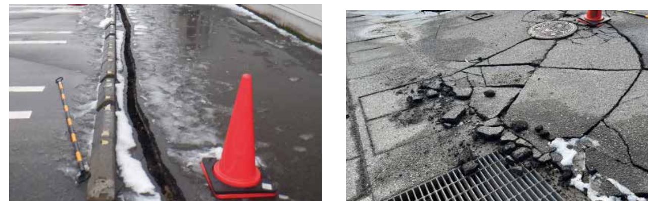
(図) 店舗駐車場に見られたクラックの様子
